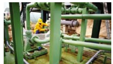
Tratamiento de agua
